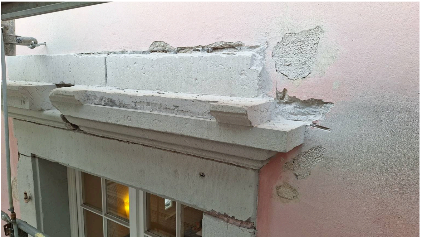
An vielen Stellen – wie hier am östlichen Torhaus – bröckelt das Mauerwerk. Foto: SSPB
